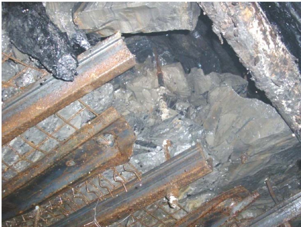
Рис. 2. Состояние контура и крепи подготовительной выработки, расположенной в сложных условиях с использованием облегченных опорных элементов и канатных анкеров
