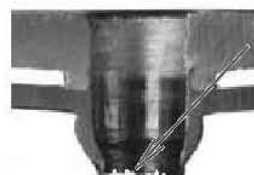
Рис. 1. Разрывы в теле узла крепления
