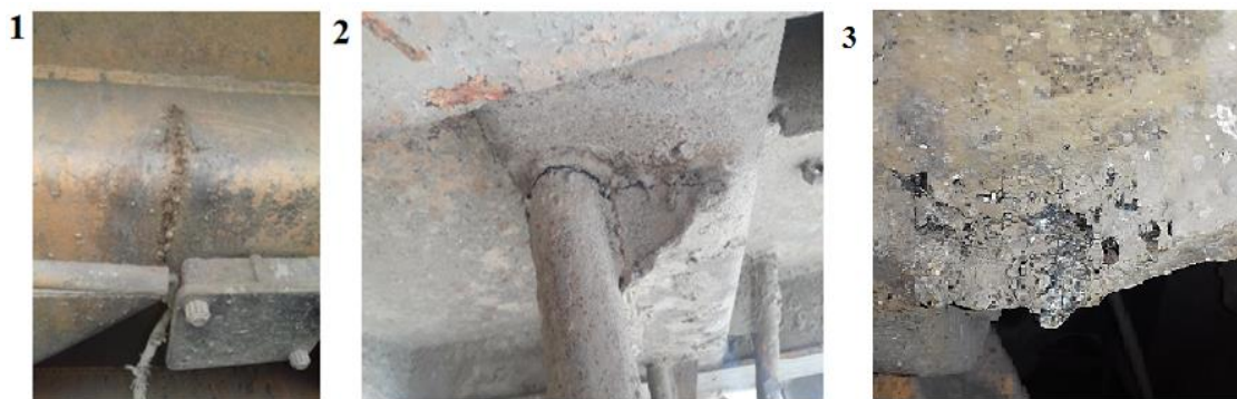
Рис. 5. Места трещинообразования: 1 – трещина контрфорсы кузова, 2 – трещина по сварному шву страховочной серьги, 3 – трещина по ремонтному шву вилки задней подвески
