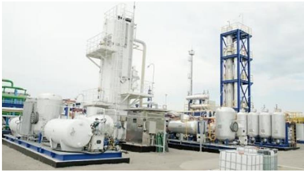
Рис. 6. Завод по сжижению природного газа Fig. 6. Natural gas liquefaction plant
