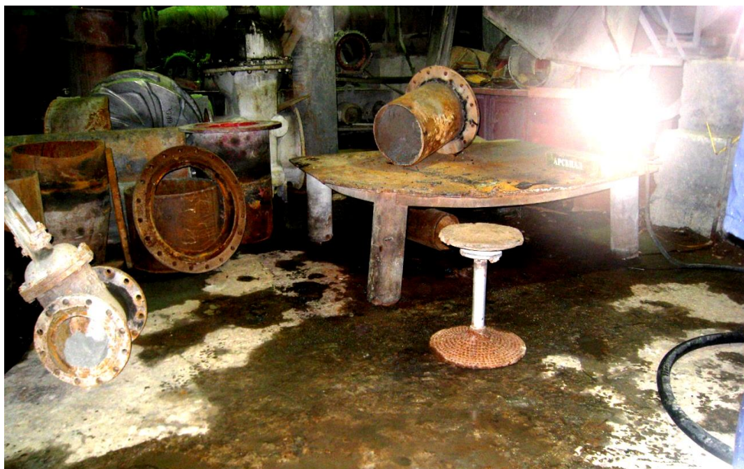
Рис. 4. Состояние сварочного поста, зафиксированное во время проведения экспресс-аудита Fig. 4. The condition of the welding station that was recorded during the express-audit
