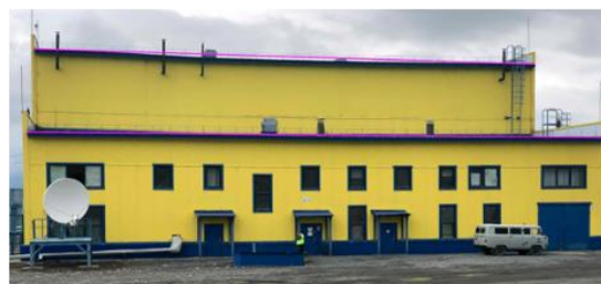
Рис. 1. Общий вид фасада здания гаража (просматривается развитие негативных деформационных процессов)
